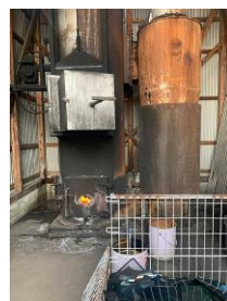
（福岡工場 焼却炉）
